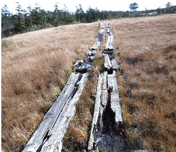
傷んでいる木道
